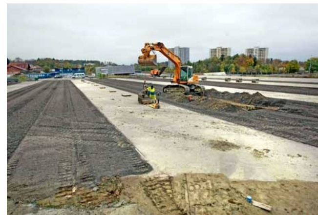
© PATRICK MARTIN | HORS-SERVICE Les travaux viennent de débuter à Vennes. Sur ce vaste espace va se dresser d’ici 2010 un grand parking d’échange de 1200 place, ainsi que le projet AquaEcopôle avec son musée-aquarium géant. LAUSANNE, LE 23 OCTOBRE 2008.
